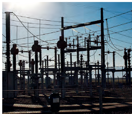
Az albertirsai transzformátorállomás elosztó berendezése
